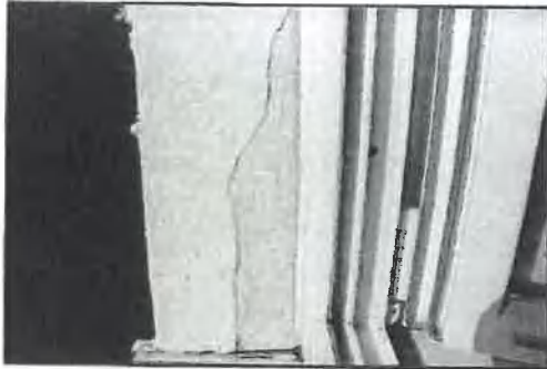
Foto Nr.: 47 – seitliche Leibungen Fehlstellen Feinputz
