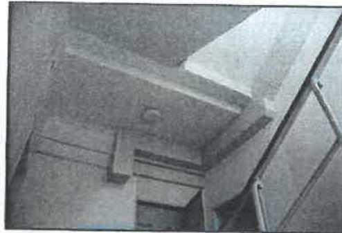
Foto Nr.: 32 – diverse Kanäle Aufputz
