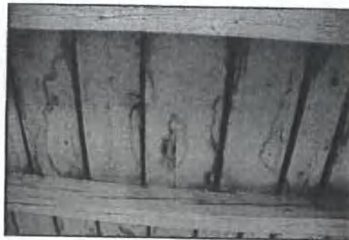
Foto Nr.: 24 – massive Kondensatflecken auf der Rauschalung Blecheindeckung
