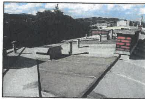
Foto Nr.: 16– Dachfläche Nord – stark angerostete Dachfläche
