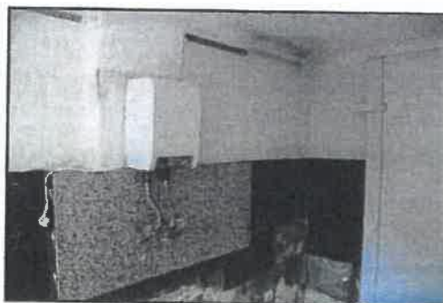
Foto Nr.: 56 – Küche – Boiler Aufputz
