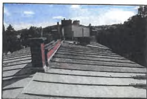
Foto Nr.: 21– massive Rostflächen, tw. Flüssigfolie ausgebessert
