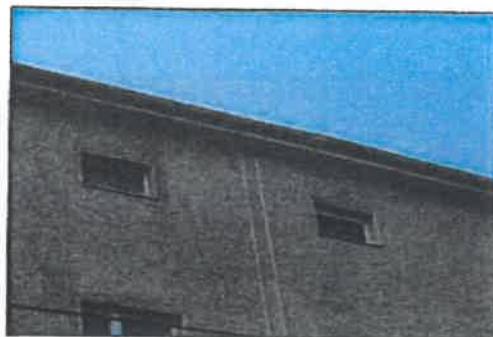
Foto Nr.: 6– lokaler Putzschaden
