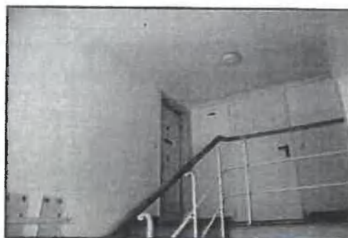
Foto Nr.: 42 – Wasserschaden Stiegenhaus
