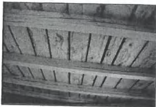
Foto Nr.: 23 – massive Kondensatflecken auf der Rauschalung Blecheindeckung
