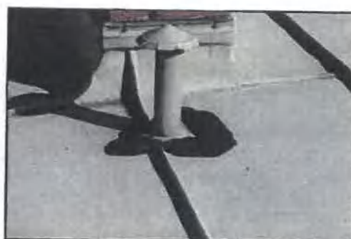
Foto Nr.: 22– massive Roststellen, tw. Flüssigfolie ausgebessert
