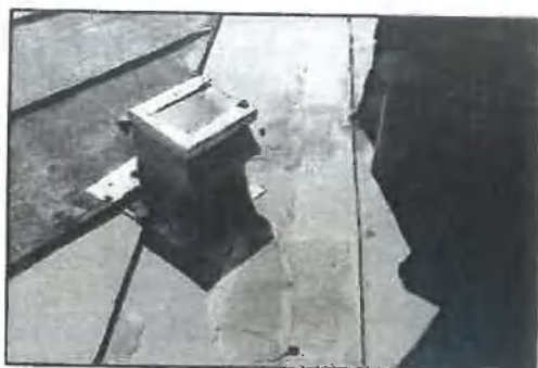
Foto Nr.: 19 – massive Rostflächen, tw. Flüssigfolie ausgebessert
