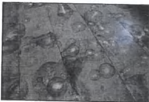
Foto Nr.: 25 – massive Kondensatflecken auf den Wärmedämmplatten
