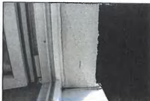
Foto Nr.: 48 – seitliche Leibungen Fehlstellen Feinputz
