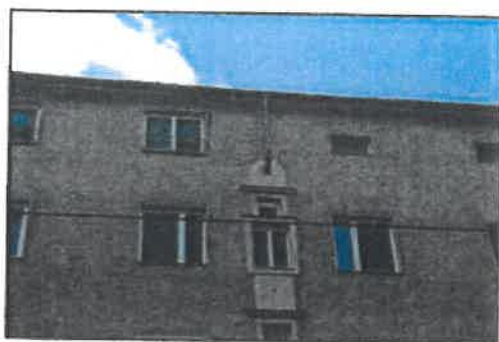
Foto Nr.: 5 – lokaler Putzschaden
