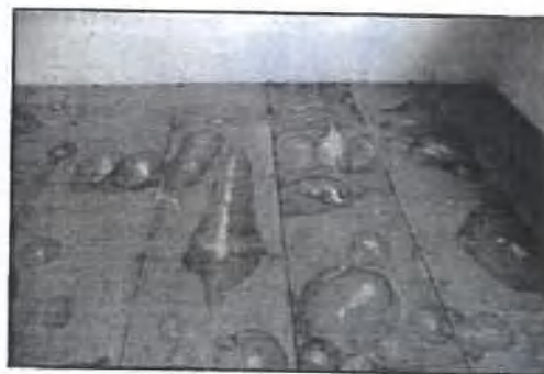
Foto Nr.: 26 – massive, tw.linienförmig Kondensatflecken auf den Wärmedämmplatten
