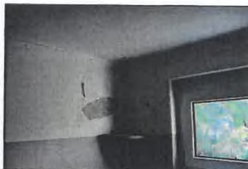
Foto Nr.: 40 – massiver Wasserschaden
