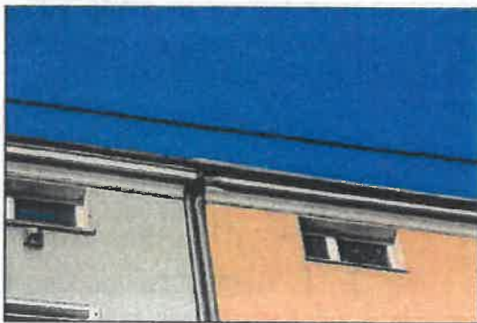
Foto Nr.: 3 Gesimse massiver Putzschaden bei Regenrohr
