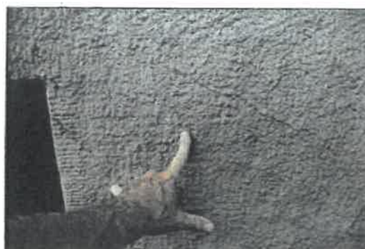
Foto Nr.: 6 Sockelbereich wiederkehrende Risse
