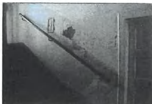
Foto Nr.: 42 massiver Wasserschaden Färbelung löst sich vom Untergrund
