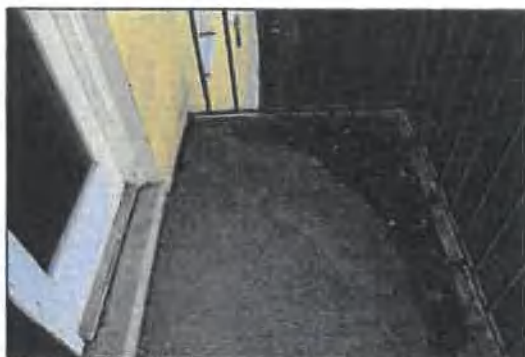
Foto Nr.: 15 Balkonplatte massive Ablagerungen Witterungseinflüsse – kein Gefälle
