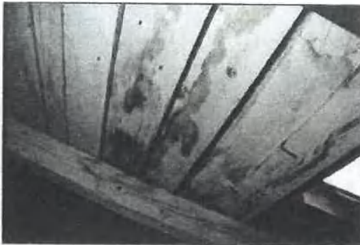
Foto Nr.: 25 Feuchtigkeitseintritte Dachuntersicht
