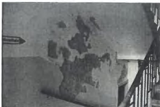
Foto Nr.: 45 Wasserschaden Steigenhaus
