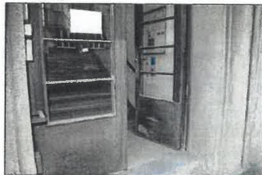
Foto Nr.: 32 Eingangsbereich Holz massive Abriebe der Holzbeschichtung
