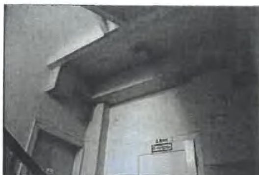
Foto Nr.: 37 Haustechnikinstallation in Schächten geführt
