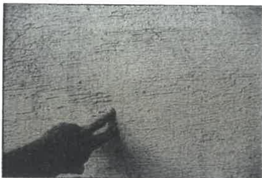
Foto Nr.: 17 Fassade netzartige Risse über die gesamte Oberfläche
