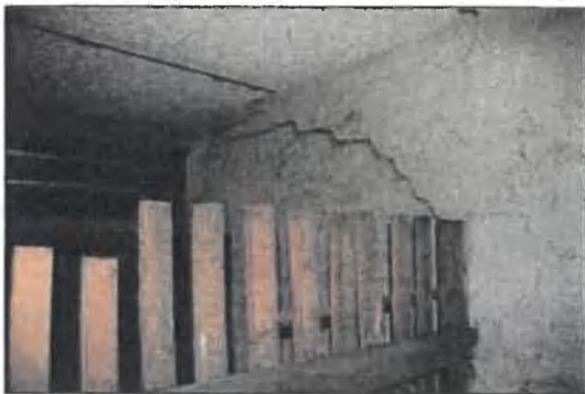
Foto Nr.: 51 horizontal abgetrepter Riss
