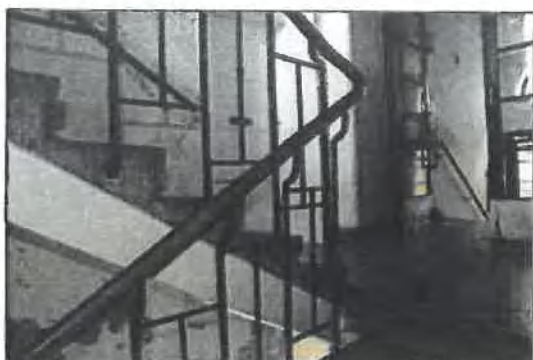
Foto Nr.: 41 Geländer Abstand vertikale Stäbe – entspricht nicht OÖ Bauordnung und OIB-Richtlinie
