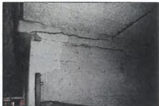
Foto Nr.: 52 horizontal abgetrepter Riss auslaufend
