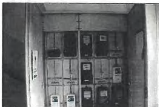
Foto Nr.: 39 E-Verteiler
