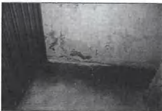
Foto Nr.: 55 Feuchteschäden Putz
