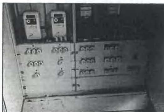
Foto Nr.: 40 E-Verteiler
