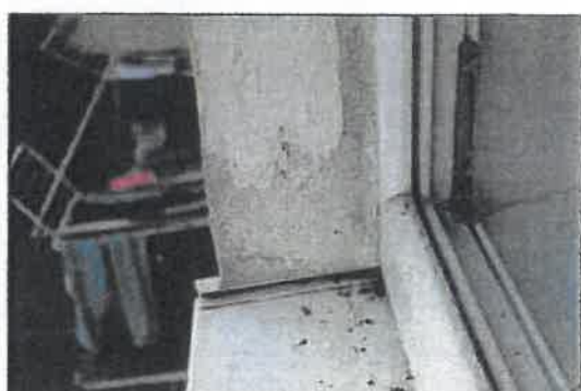
Foto Nr.: 62 Fensterleibung massive Putzschäden
