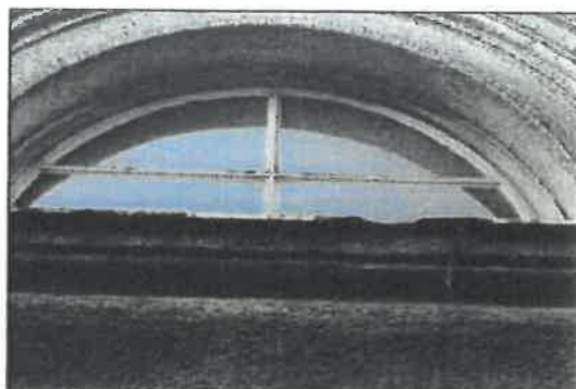
Foto Nr.: 5 Portal Haupteingang, Blechabdeckung Rostschaden
