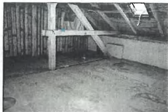
Foto Nr.: 26 Dachbodendecke gedämmt, Kalkränder nach Wassereintritte sichtbar
