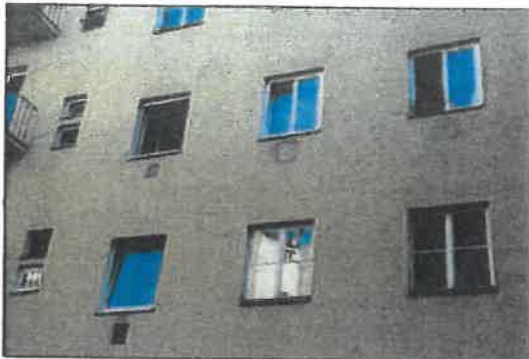
Foto Nr.: 9 Außenwandgeräte Gas WD verschlossen
