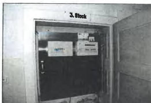
Foto Nr.: 38 Stockwerksverteiler
