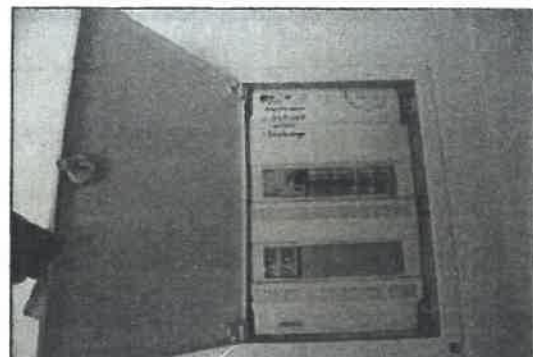
Foto Nr.: 58 E-Verteiler
