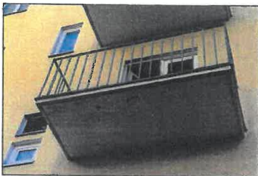
Foto Nr.: 11 Balkonuntersicht massive Wasserschäden, Betonabplatzungen
