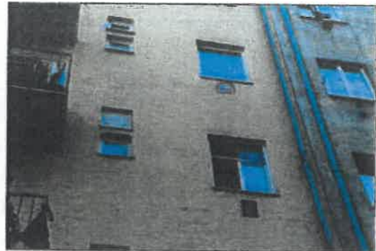
Foto Nr.: 10 Außenwandgeräte Gas WD verschlossen
