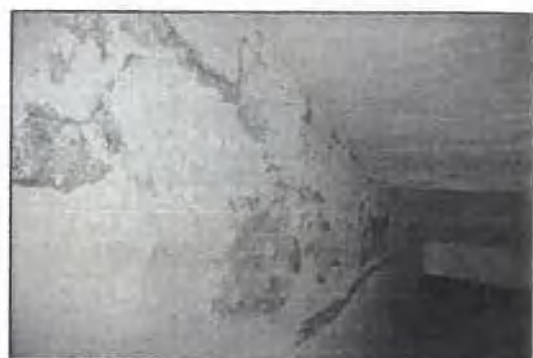
Foto Nr.: 56 Feuchteschäden Putz
