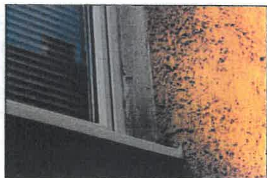
Foto Nr.: 4 Fensterleibung Putzschaden
